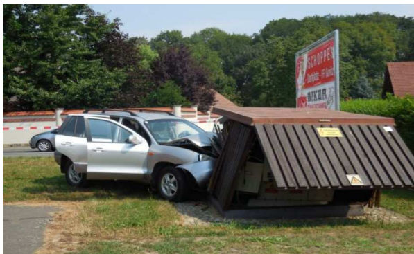
„Stromabschaltung“ am 10.000 V Trafo !
